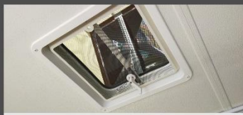
換気システム
